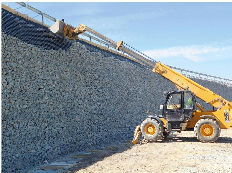
Figura 74 - Gabiões posicionados próximos a rodovias além da contenção das margens das vias como elementos acústicos.
