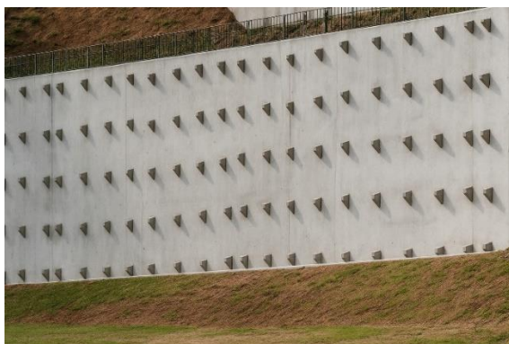
Figura 5. Muro de cortina atirantada.
